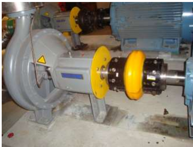
Fig. 10 Isolerande koppling på båda pumparna, se figur ovan.
