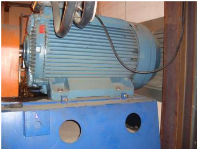
Fig. 12 Bilden visar mätobjektet vid mätning 3. Den högra kabeln är extra potentialutjämningen.
