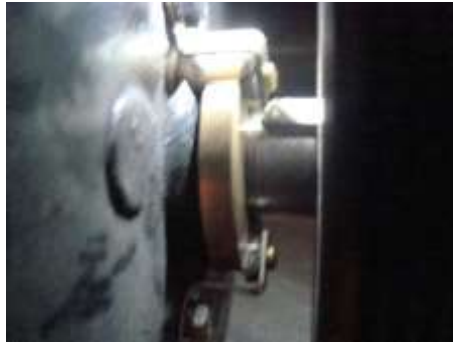
Fig. 8 Bilden visar den monterade släpringen som potentialutjämnar axel och chassi på ventilationsanläggning nr 12.
