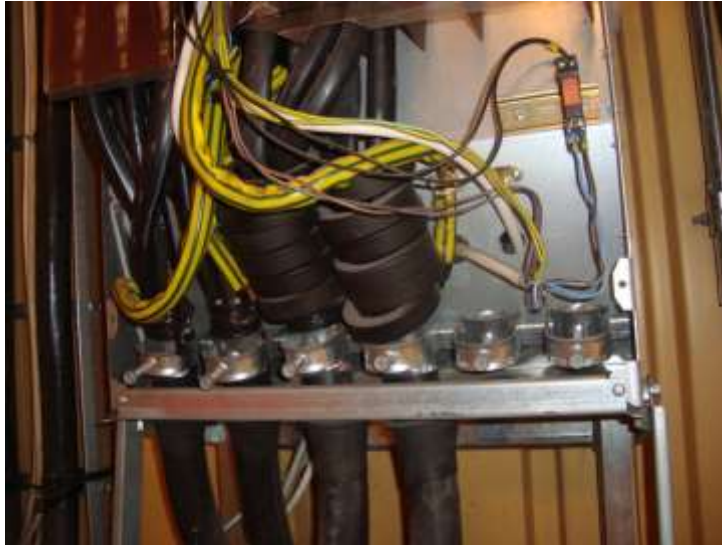
Fig. 13. Ferritringarna som är monterade på matande kabel efter frekvensomriktaren fungerar som ett common-mode filter då dessa agerar som en lokal induktans för icke sinusformade strömmar.
